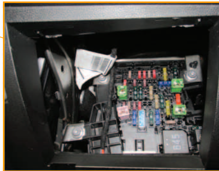
Relais- und Sicherungshalter SC im Fahrgastraum unten links, hinter dem Ablagefach
